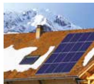
Bâtiment mal isolé
