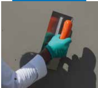
Application de la 1 ère passe à la spatule, 2 ème passe après 1 h (à +20°C)
