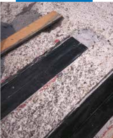
Plats Carboplate engravés dans le béton
